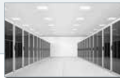
Structure de serveurs centralisée
