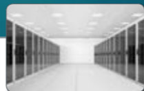
Estructura de los servidores centralizada
